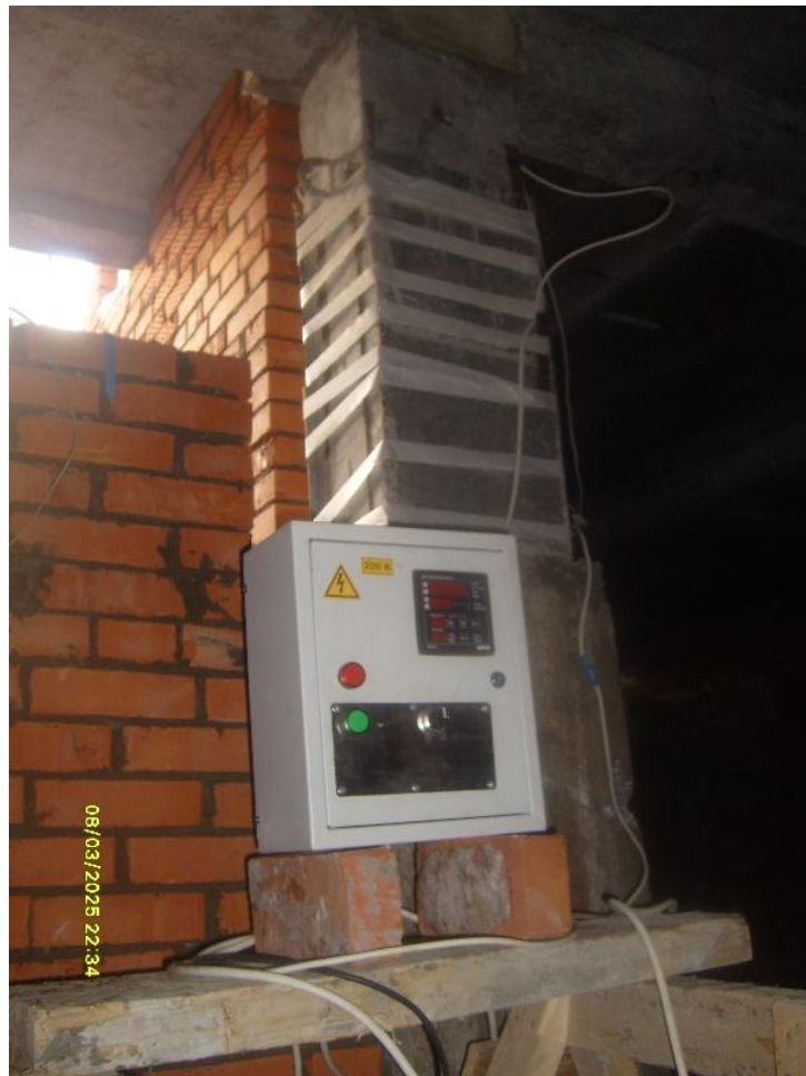
Рис. 5.9. Установка плоских электронагревателей для электротепловой обработки штепсельного (шпунтового) соединения колонны и фундамента
