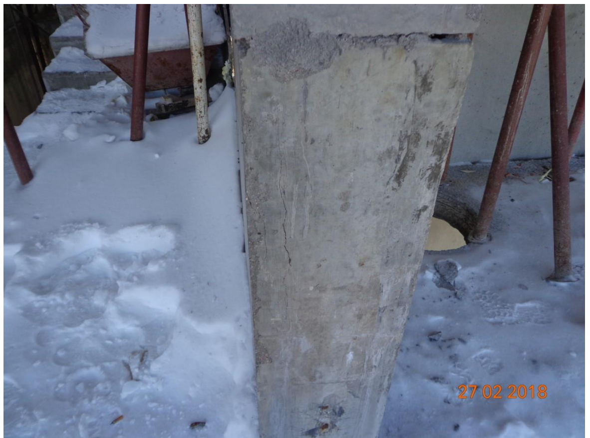
Рис. 1.5. Вариант трещины в стыке от промерзания бетона
