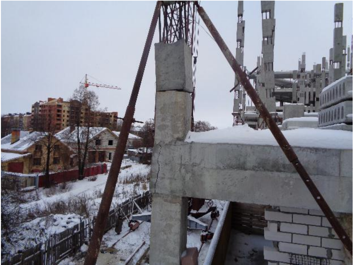
Рис. 1.6. Трещина в стыке колонны и перекрытия от промерзания бетона
