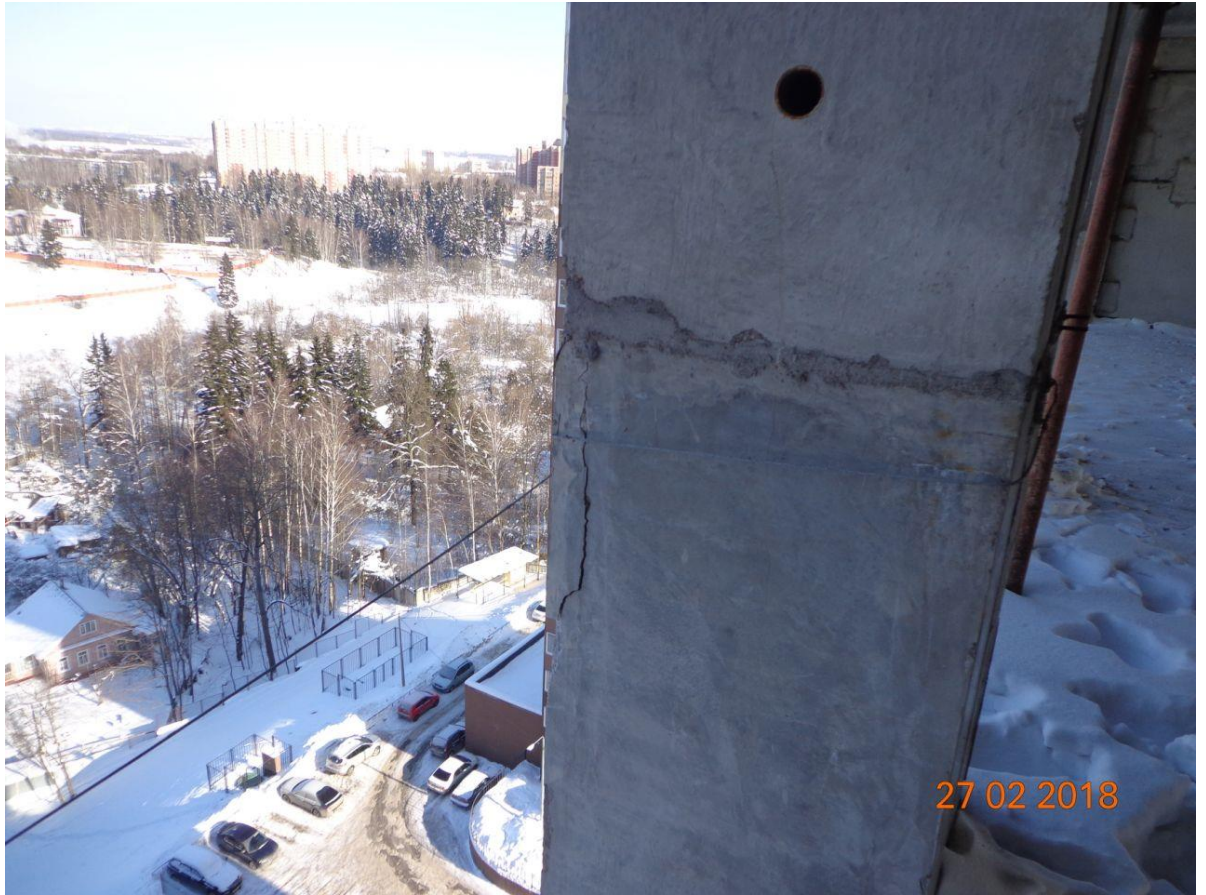
Рис. 1.4. Трещина в стыке от промерзания бетона
