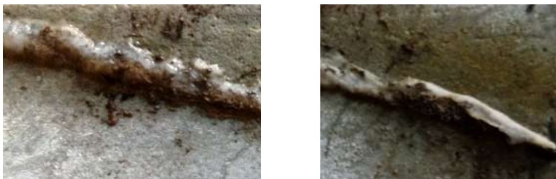
Рис. 4.6. Снимки поверхности цементного камня при биоповреждении
