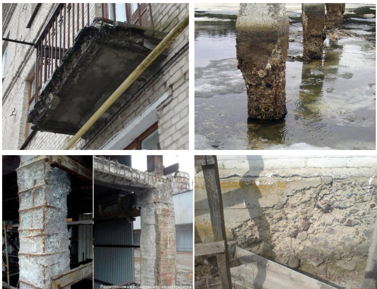
Рис.1.2. Демонстрация негативных последствий при коррозии бетона первого вида
