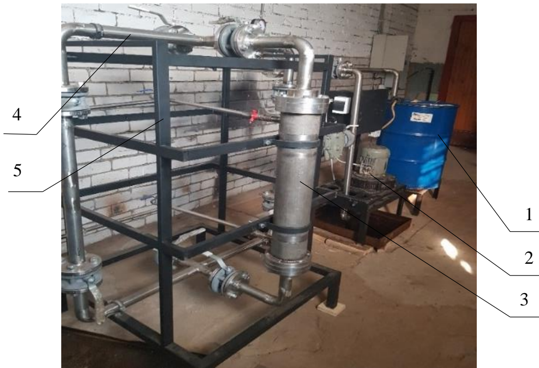
Рисунок 7.5 – Опытно-промышленная ультрафильтрационная установка: 1 – Бочка с исходным маслом; 2 – насосная станция; 3 – модуль ультрафильтрационный; 4 – трубная обвязка с управляющей арматурой; 5 – несущая система
