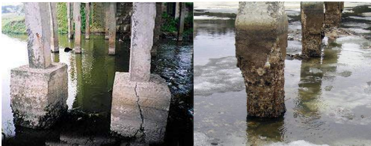
Рисунок 1.4. Разрушение железобетонных опор мостов под действием вод пресного водоёма (обтекание жидкой средой поверхности конструкции)
