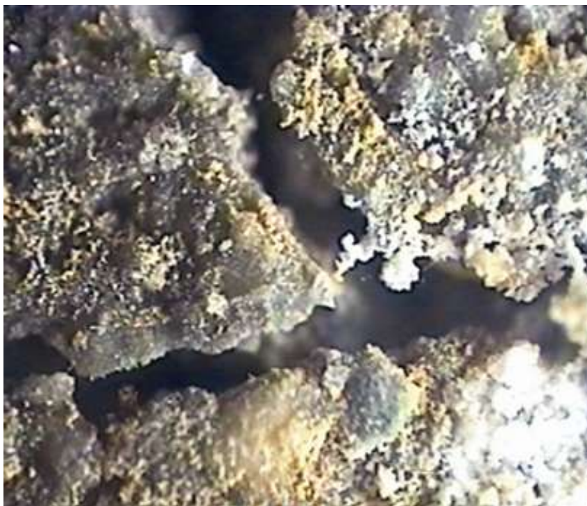
Рисунок 1.7. Трещинообразование бетона при возникновении в нём системы «этtringит – таумасит»
