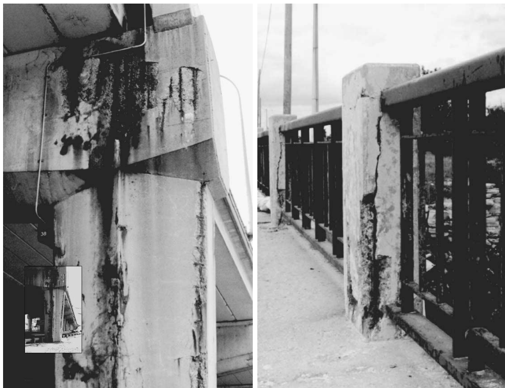
Рис. 1.3. Разрушение бетона, вызванное коррозией стальной арматуры
