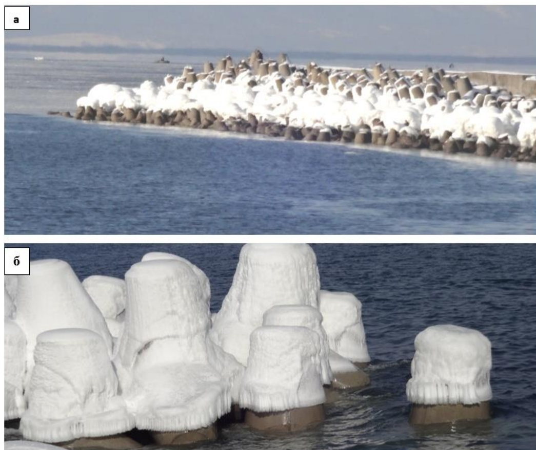
Рис. 3.8. Вид оградительных сооружений К2 в зимний период: а – общий вид оградительного сооружения; б – условия эксплуатации конструкций в зоне переменного уровня
