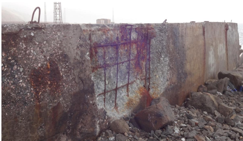
Рис. 3.13. Состояние железобетонных конструкций волноотбойной стенки в зоне обрызгивания морской волной на объекте X1 после 20-летнего срока эксплуатации
