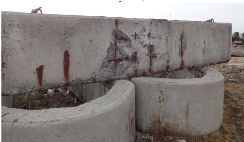
Рис. 3.14. Состояние железобетонных конструкций после 5-летнего нахождения в зоне обрызгивания морской волной на объекте X1
