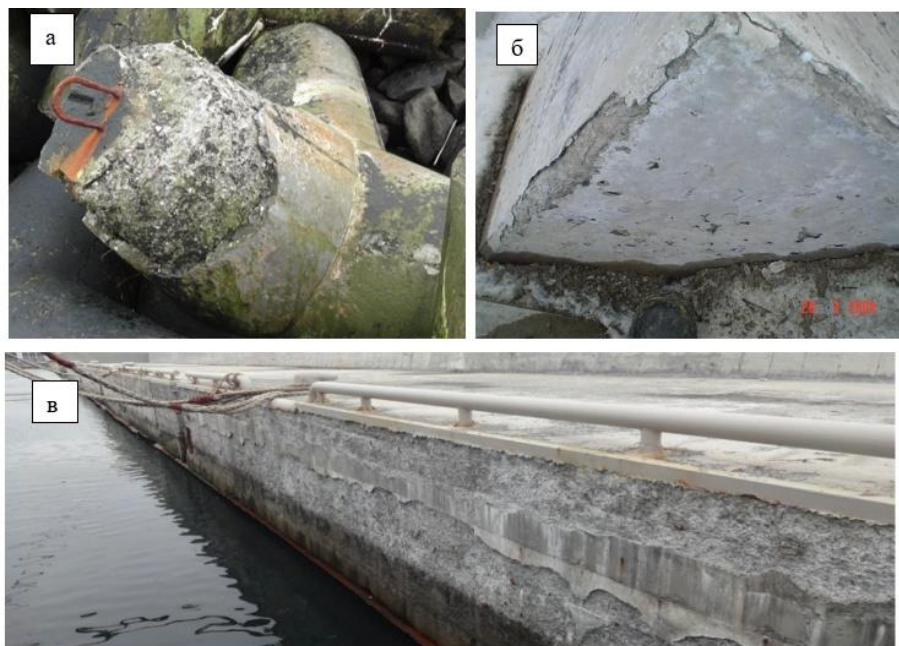
Рис. 3.10. Отслоение поверхностной части бетона с последующим объемным разрушением внутренних слоев бетона: а) конструкция (тетрапод) после 40 лет эксплуатации на объекте Х2-1; б) конструкция (гексабит) после первого зимнего сезона на объекте К3-1; в) конструкция причальной стенки после первого зимнего сезона на объекте К3-2
