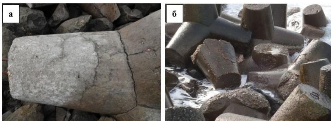
Рис. 3.11. Вид разрушения P_T у тетраподов на объекте Х2-1: раскрытие трещин в бетоне (а) и последующее разрушение на отдельные части от воздействия прибойной волны (б)
