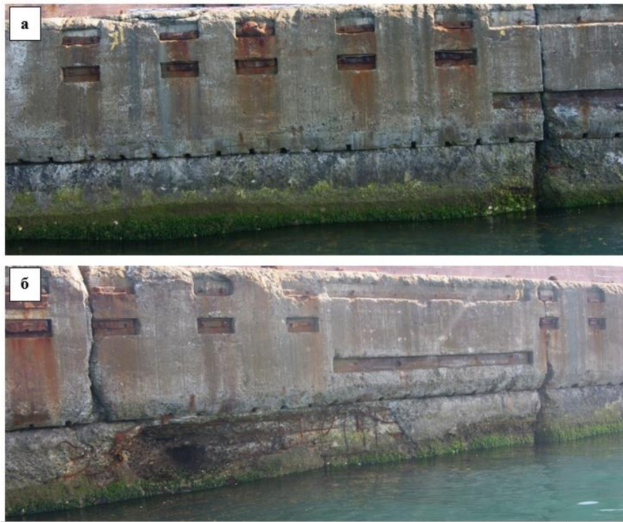
Рис. 5.10. Общий вид отдельных участков причальной стенки сооружения К1 (срок эксплуатации 80 лет): а) конструкции с поверхностным разрушением вида P_{II} ; б) конструкции с локальными разрушениями вида P_V на глубину 300 мм
