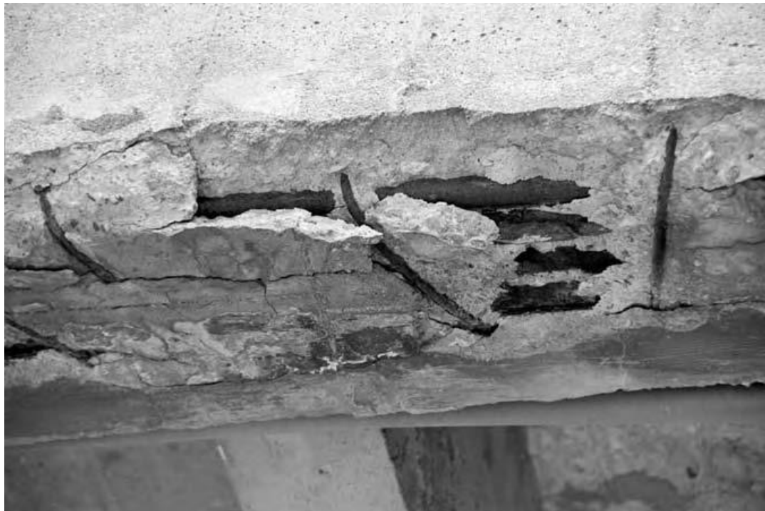
Рис.1.5. Разрушение железобетонного элемента мостовой конструкции, вызванное коррозией арматуры (причина коррозии – карбонизация защитного слоя бетона, проникновение хлоридов) [23]
