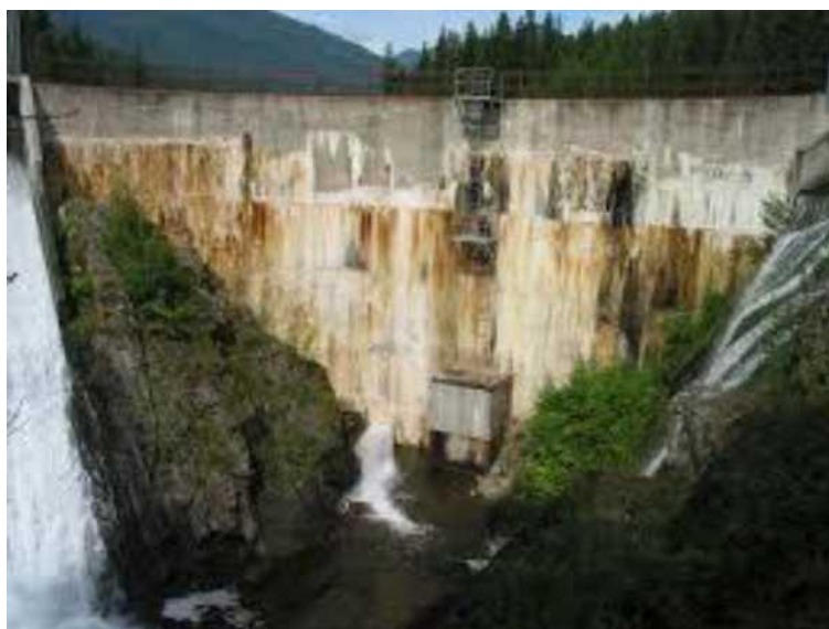
Рис. 1.4. Продукты выщелачивания на стене дамбы
